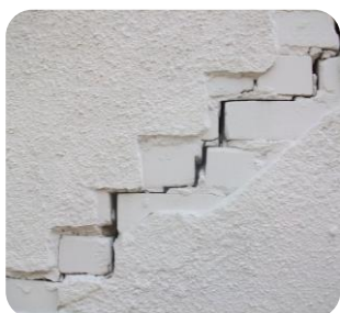
Grietas en las escaleras
