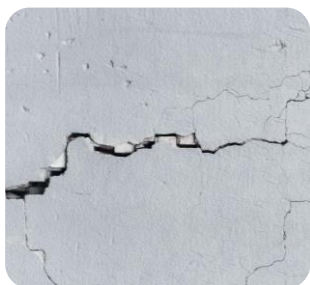
Grietas en la pared
