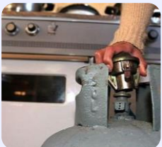
Conexiones de gas
